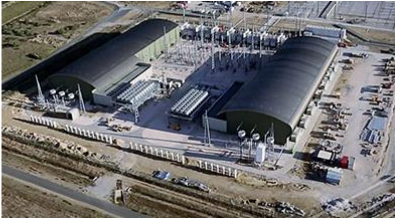
Interconnecteur Inelfe de 2000 MW (VSC)
