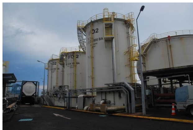
Stockage du combustible
