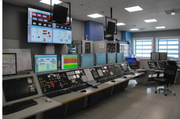
Salle de contrôle commande
