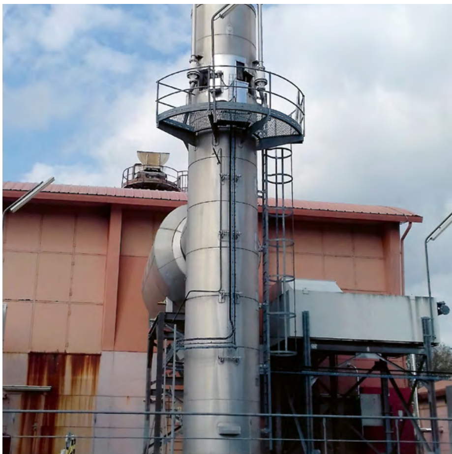
Cheminée d'un turbocompresseur, site de Gournay.
