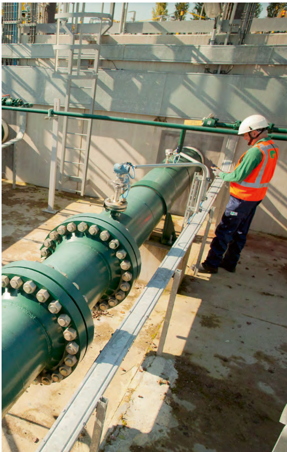
Le réseau Megal en Allemagne : la station de compression d'Öbergailback.
