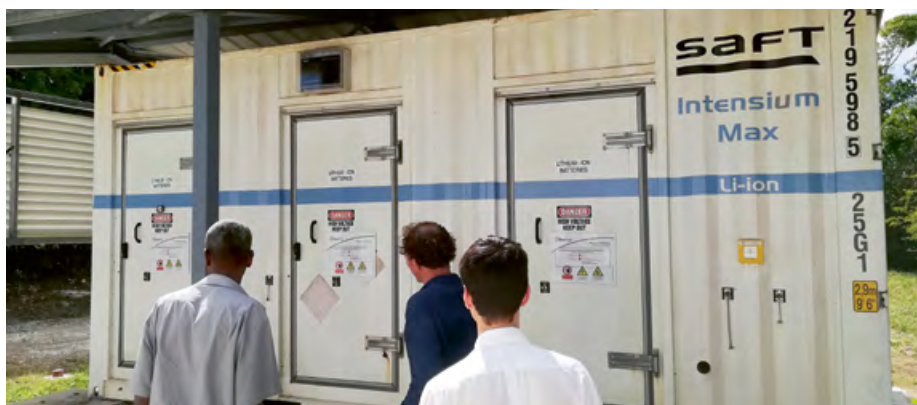
Installation de stockage (batterie) en Guadeloupe.
