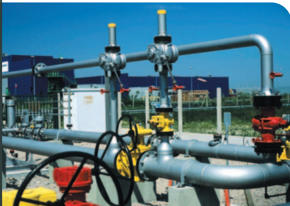
Poste de livraison* d'un gros consommateur industriel
