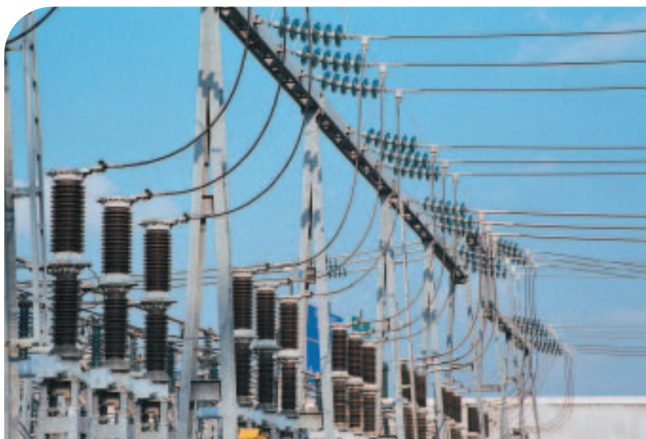
Poste électrique 225 000 Volts de Portet-Saint-Simon près de Toulouse
